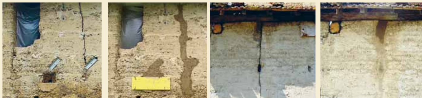
Exemples de reprise de fissure.
