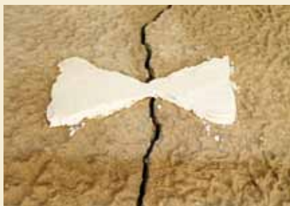
Témoin en plâtre sur une fissure
